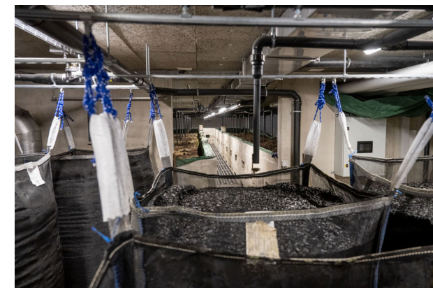
Photo: Aufbereitung und Wiederverwertung von Abwasser in la Bistoquette, Plan-les-Ouates GE.
